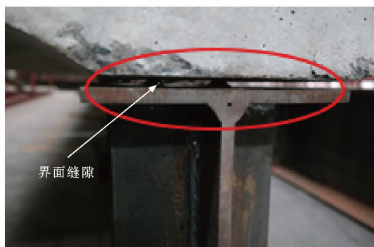
图1 钢-混结合界面缝隙
