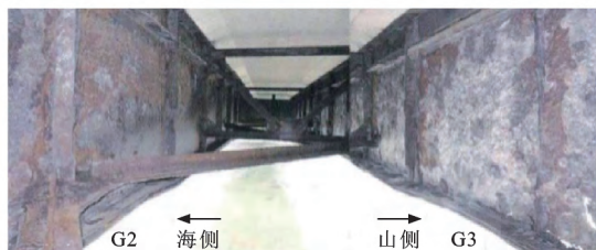
图 28 耐候钢主梁内侧严重腐蚀
