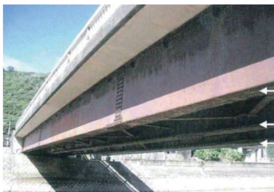
图 27 腐蚀劣化的日本耐候钢桥
