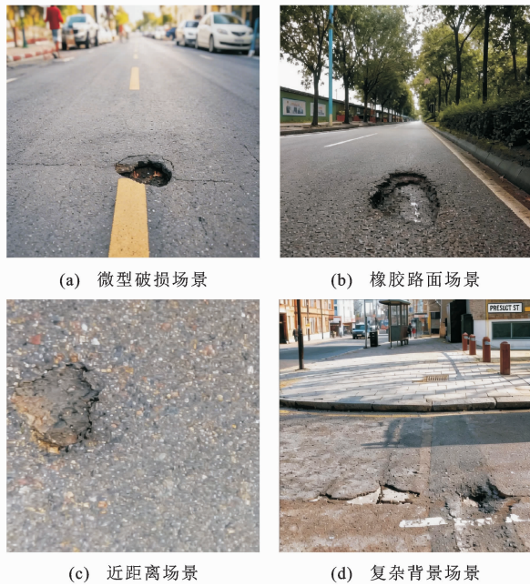
图5 普通破损坑洞示例
