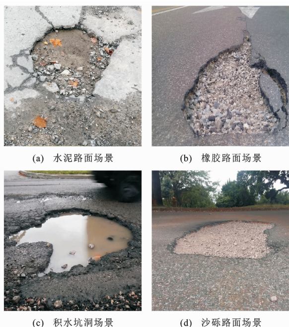
图 9 重度破损坑洞示例
