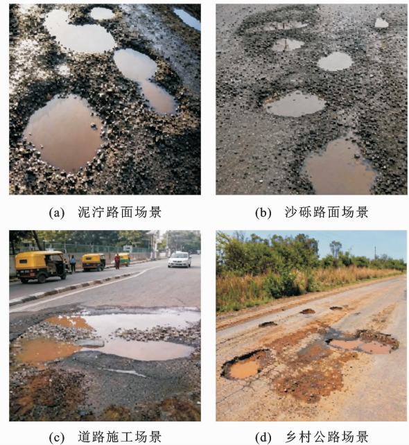
图7 完全破损坑洞示例
